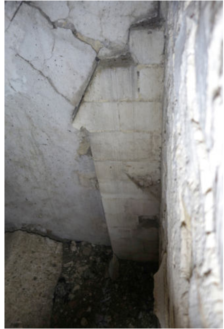
Fig. 58 : Contrefort sur lequel s'appuie la maçonnerie de la chapelle de la Vierge
