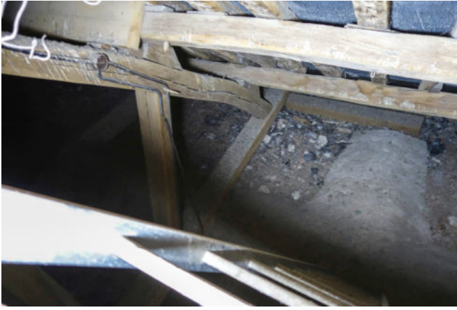
Fig. 57 : Demi-ferme de la charpente couvrant la chapelle de la Vierge au nord de l'église
