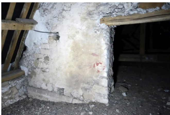
Fig. 41 : Mur séparant le comble entre la nef et le chœur, au-dessus de l'arc-diaphragme
