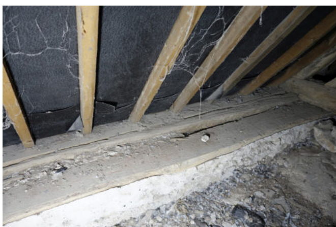
Fig. 55 : Détail des sablières récentes intégrant la sablière ancienne (travée la plus orientale)
