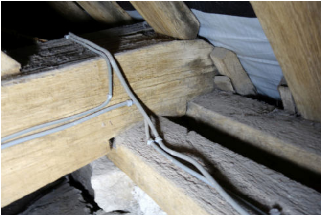
Fig. 45 : Détail de l'assemblage des entrails aux sablières des fermes de la charpente de la nef
