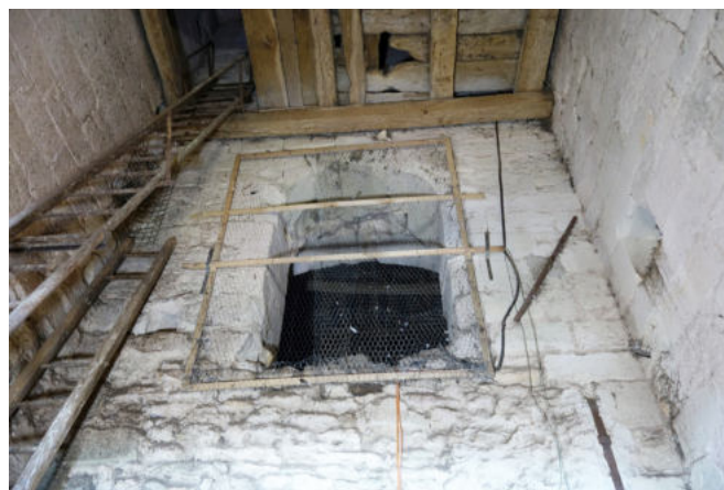
Fig. 38 : Porte d'accès aux charpentes de la nef et du chœur depuis le premier étage du clocher
