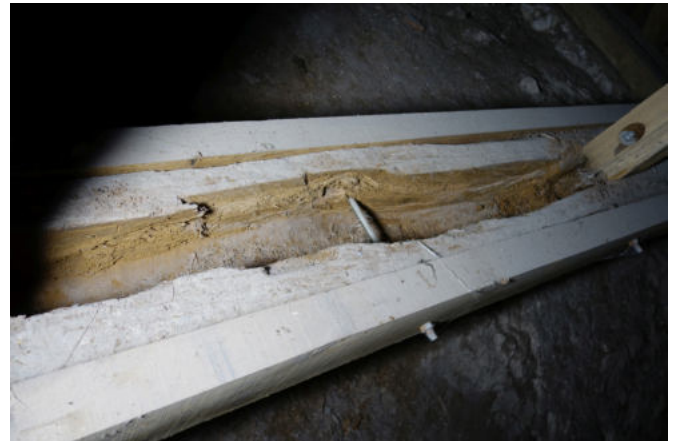
Fig. 46 : Détail des dégradations des entrails des fermes de la charpente de la nef
