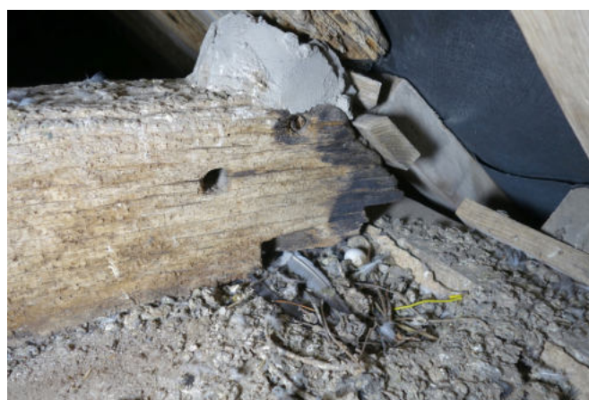
Fig. 56 : Détail de l'about d'un entrain d'une ferme de type 2 avec la taille pour son assemblage à la sablière
